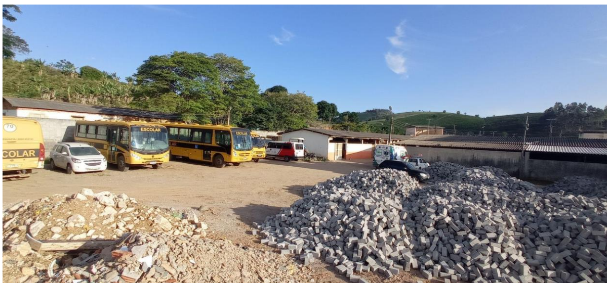
Figura 3.11 - Entulho de construção civil no terreno
