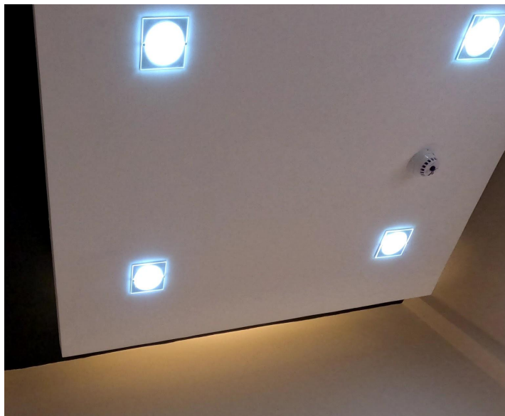
Luzes dos espelhos e teto funcionando. Fonte: Imagens de Paloma Hagen, 2023.
