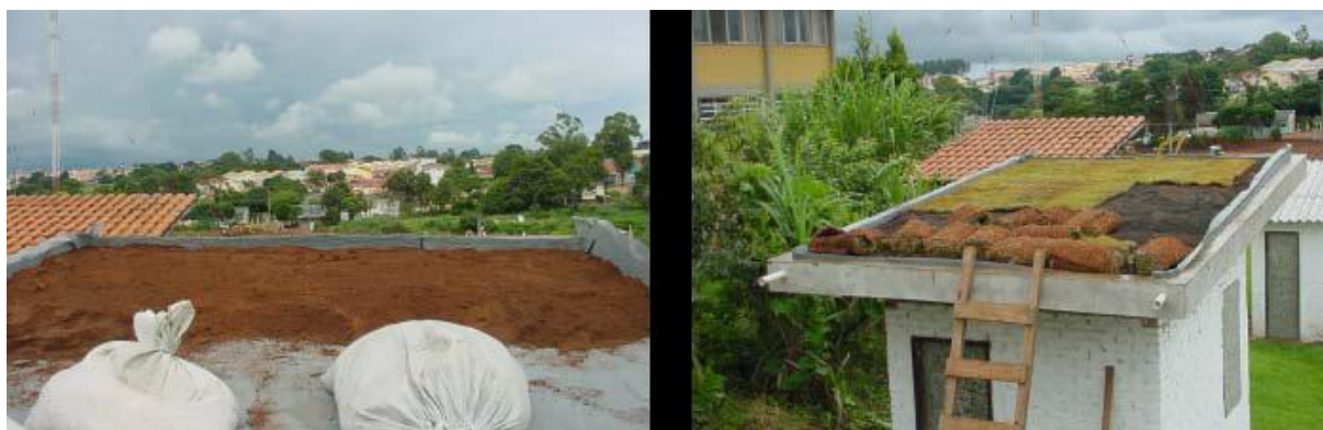
Figura 24 - Colocação de substrato sobre o geocomposto e colocação da grama Fonte: Lima (2004).
