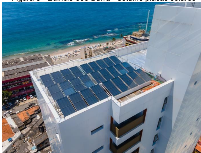
Figura 8 - Edifício 535 Barra - detalhe placas solares
