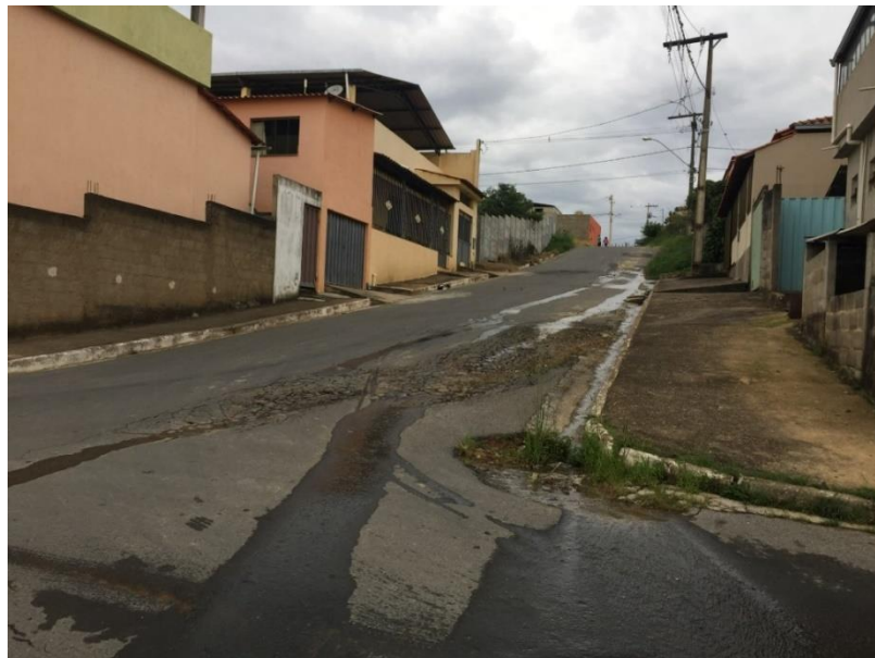
Imagem 14 – vazamento de água no bairro Vila Brasil (05/12/2019)
