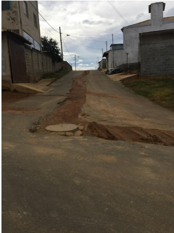
Imagem 13 - Valas sem remendos no bairro Vila Brasil (10/12/2020)
