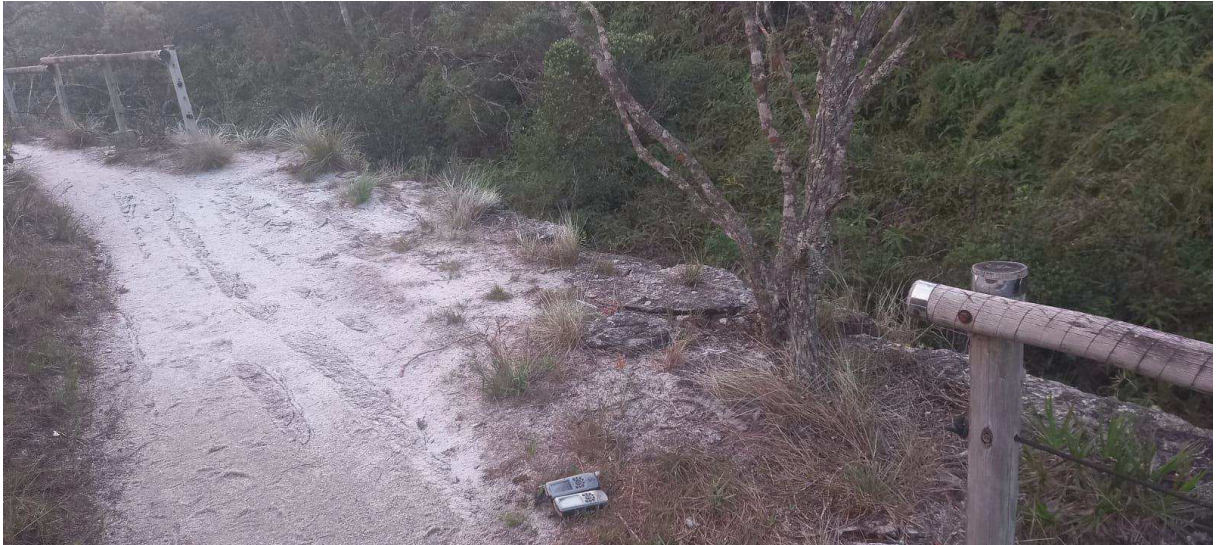
Figura 23 – Descontinuação do guarda-corpo no Paredão de Santo Antônio.
