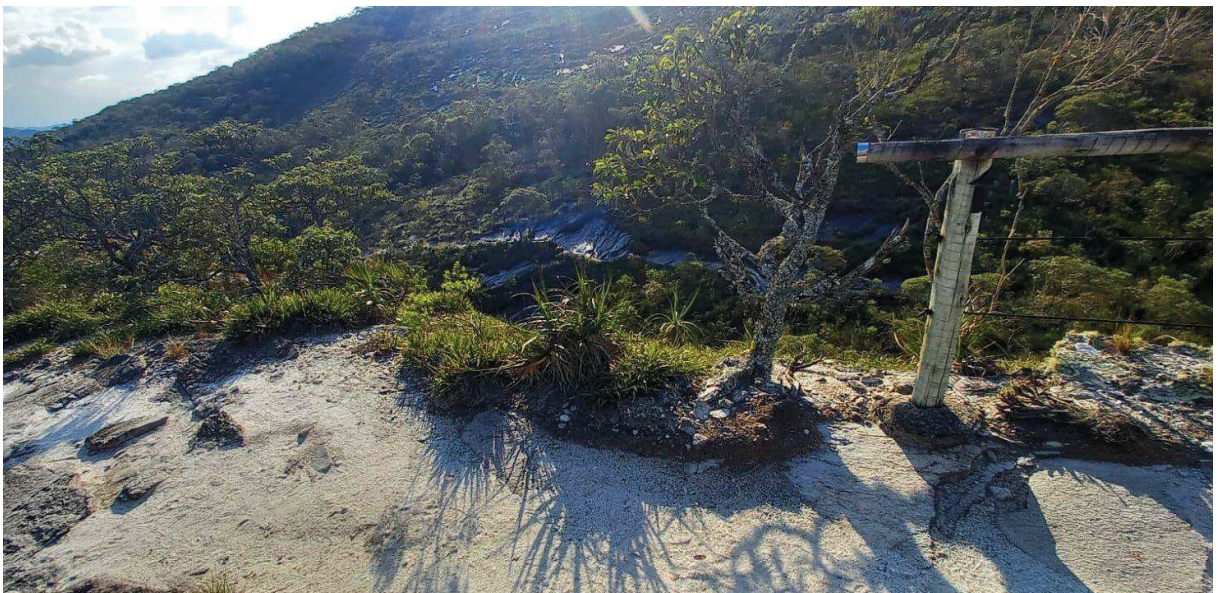
Figura 22 – Descontinuidade do guarda-corpo no Paredão de Santo Antônio.
