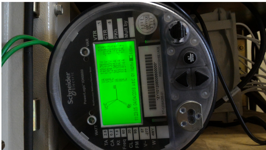
Figura 94 – Medidor de Energia Schneider Power Logic ION8600.
