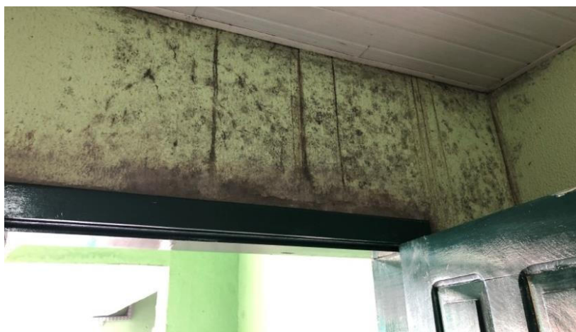
Figura 10 - Infiltrações e mofo na parede da porta de entrada da Biblioteca
