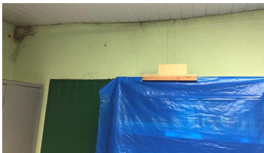
Figura 9 - Infiltrações por goteiras e necessidade de cobertura dos livros
