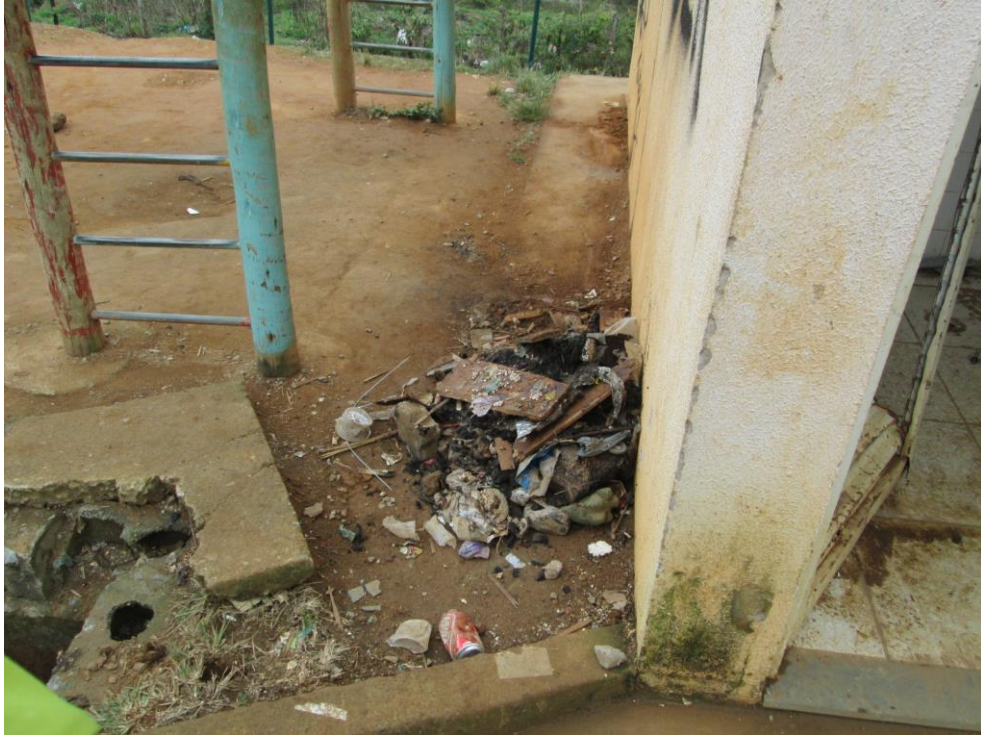
Figura 21: Sujeira no condomínio: lixo na área de lazer. Fonte: ZAMBRANO, 2014a.
