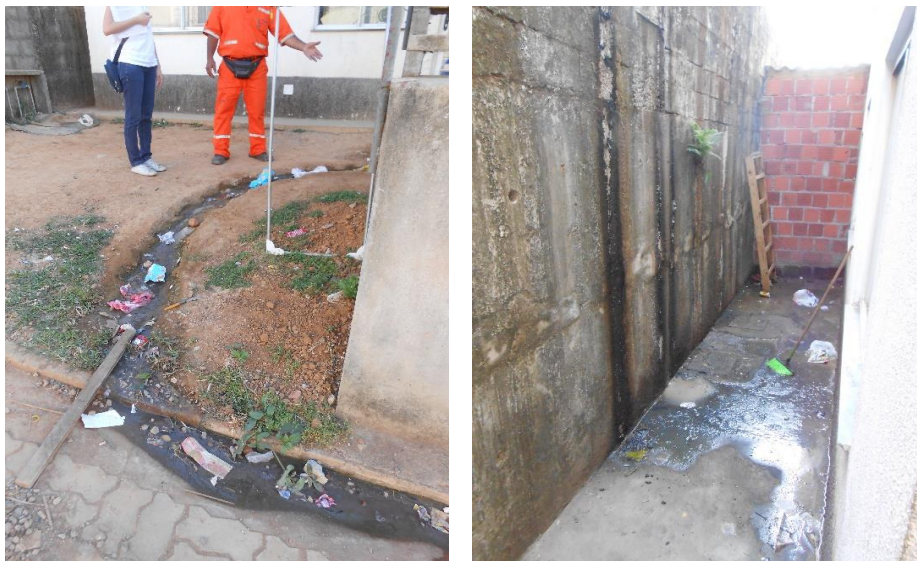
Figura 24: À esquerda, vazamento de esgoto por entupimento da tubulação. À direita, vazamento de esgoto de uma das unidades habitacionais escorrendo para os fundos de outra casa. Fonte: ZAMBRANO, 2014a.
