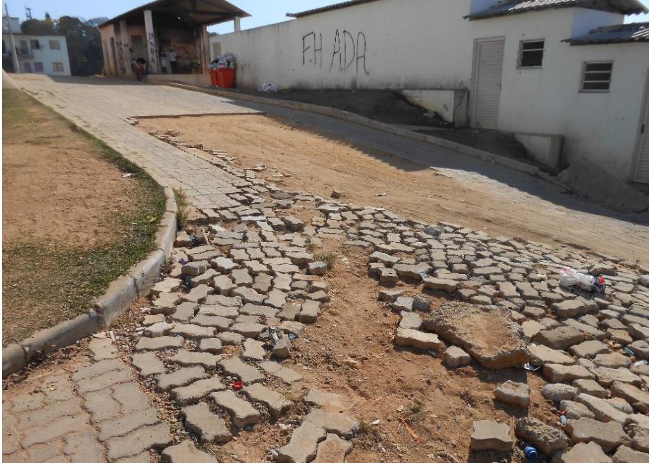
Figura 23: Precária condição do calçamento do condomínio. Fonte: ZAMBRANO, 2014a.
