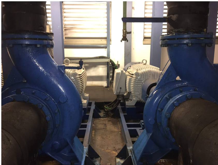
Figura 15 – Bomba centrífuga estudada
