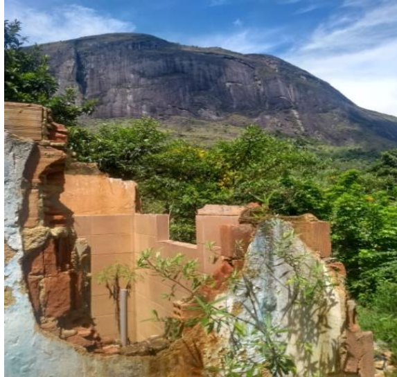
Figura 27: Ruína casa 3 (alvenaria)
