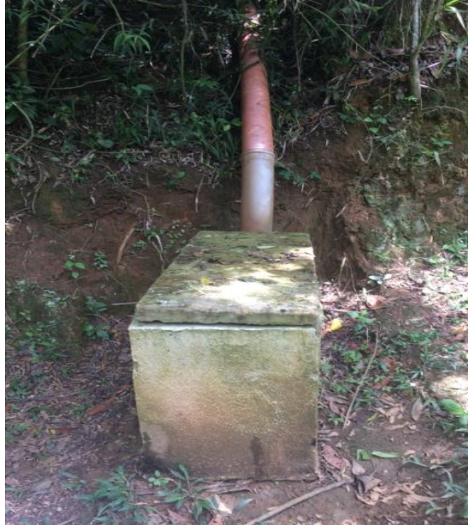
Figura 46: Caixa que retém água vinda da fossa
