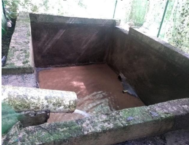
Figura 44: Caixa reservatório de água da nascente para deposição de sedimentos
