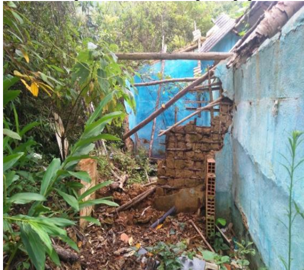
Figura 25: Ruína parte interna casa 1 (pau-a-pique e alvenaria)
