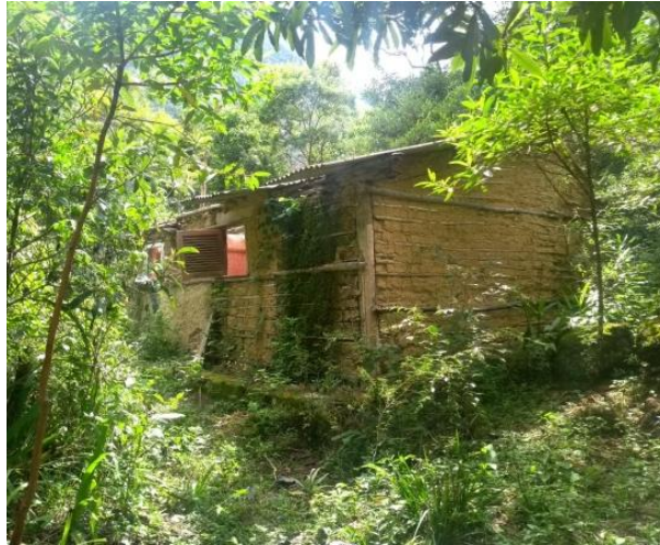
Figura 24: Ruína parte externa casa 1 (pau-a-pique)
