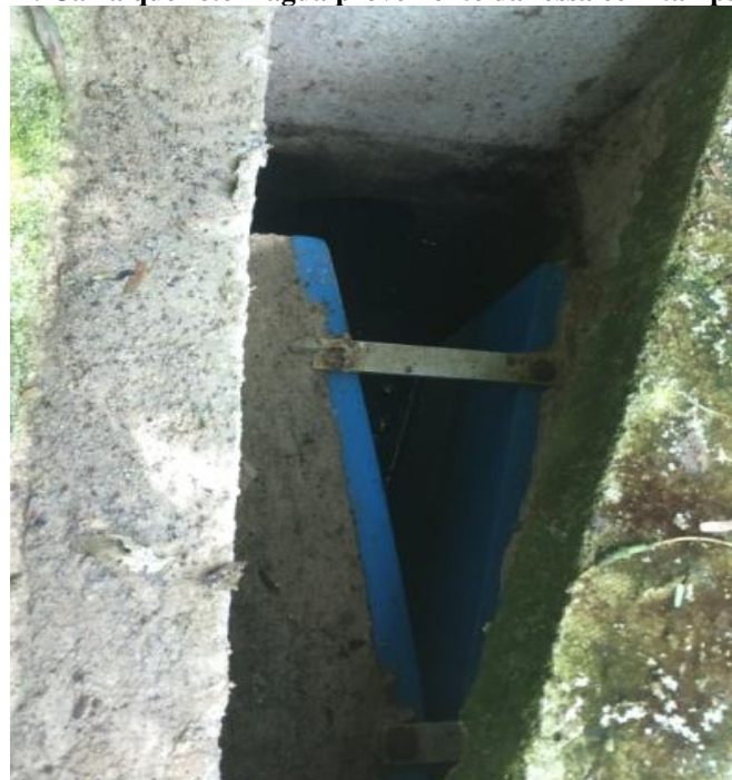
Figura 47: Caixa que retém água proveniente da fossa com tampa aberta
