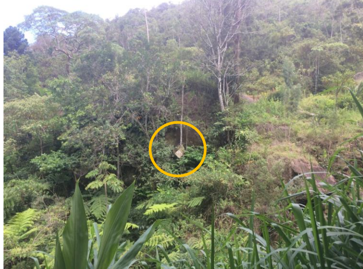
Figura 34: Parte de estrutura de construção pendurada na encosta
