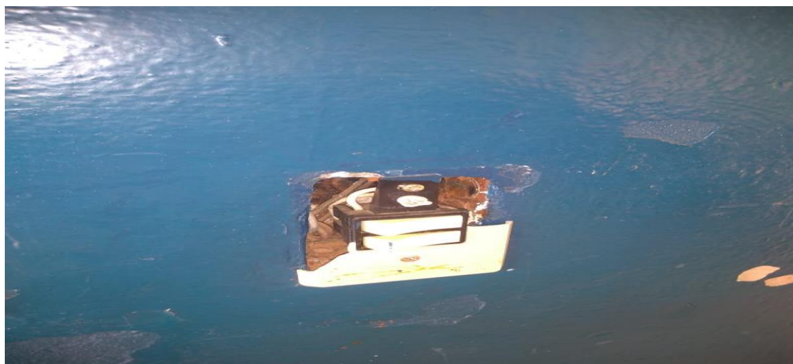
Figura 2 - Interruptor de energia danificado
