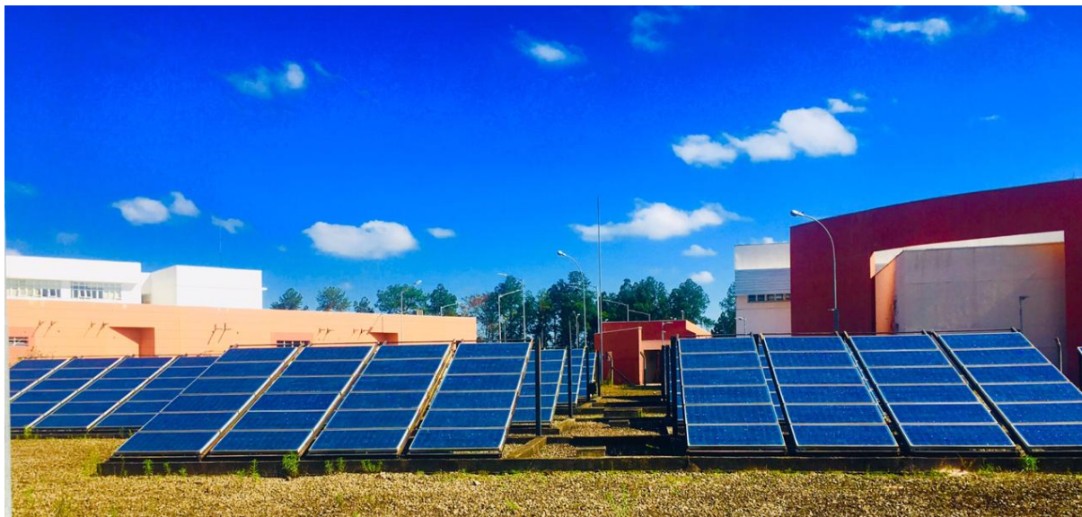
Fotografia 1 – Painéis Fotovoltaicos do Labsolar da UFJF.
