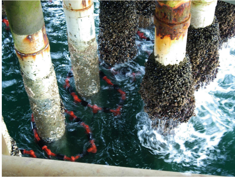
Figura 1.8: Acúmulo de vegetação no perímetro dos pilares.[20]
