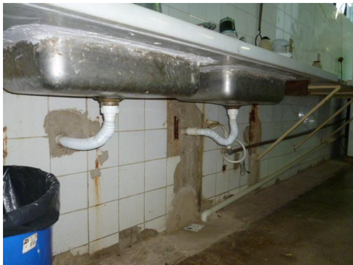
Figura 7 – Instalações hidráulicas da cozinha da Escola Estadual A
