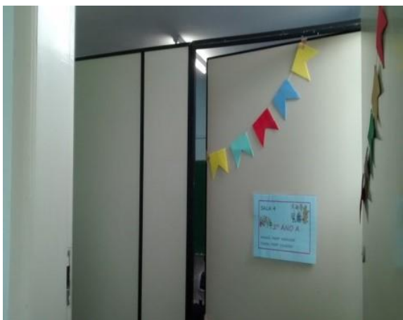
Fotografia 13 Sala do 2º ano separada por divisórias de PVC.
