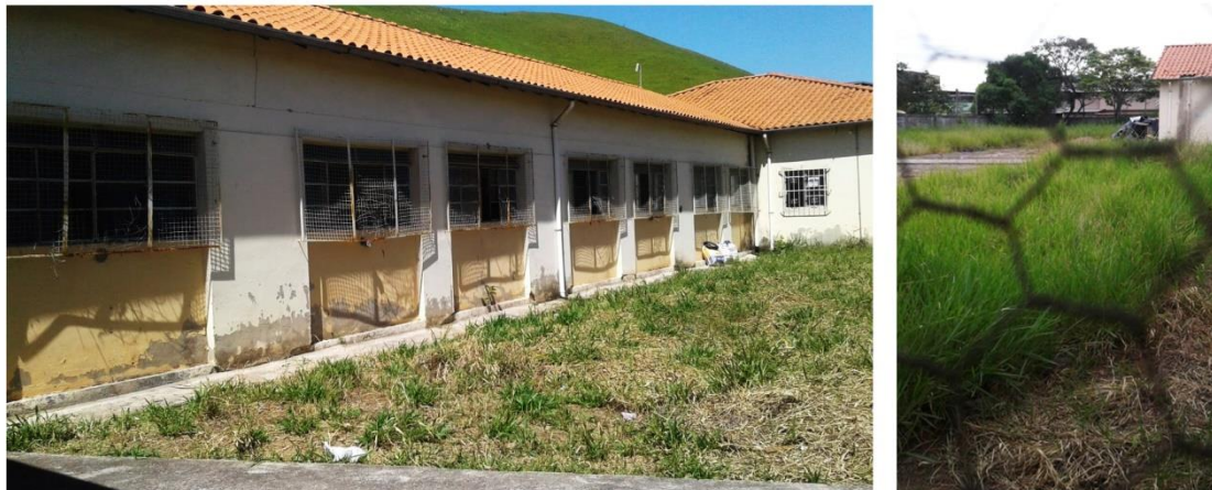
Figura 4 - dois registros da área não aproveitada: à esquerda fotografia realizada em dezembro de 2018 mostra janelas com sinais de arrombamento; à direita foto de maio de 2019 na qual é possível ver o mato alto.
