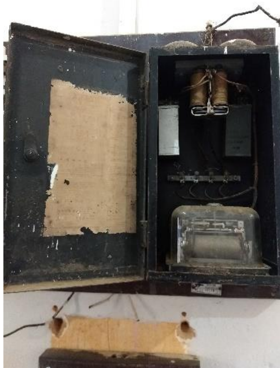
Figura 11 - Equipamento de telefonia (Interior)
