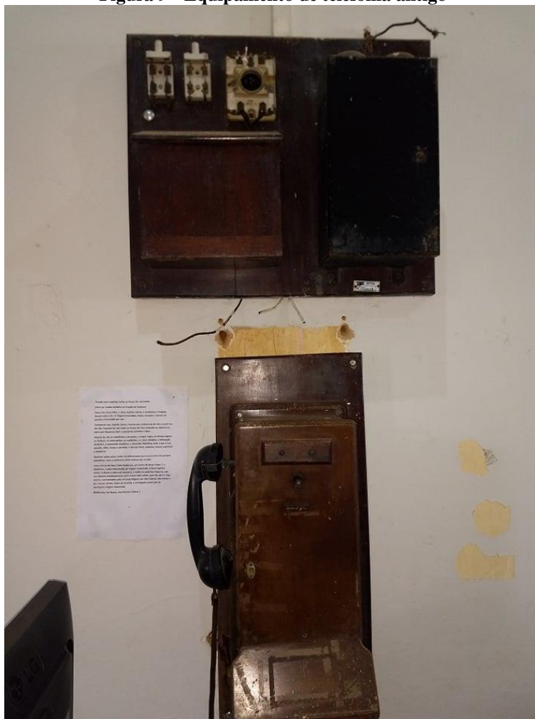
Figura 9 - Equipamento de telefonia antigo
