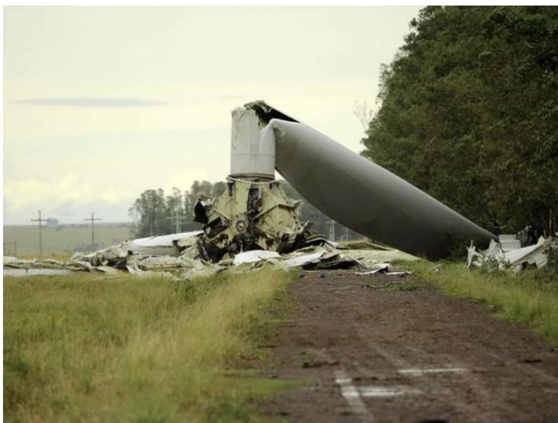
Figura 8 – Torre eólica caída no Complexo do Chato. (Fonte: Ribeiro [2014]).
