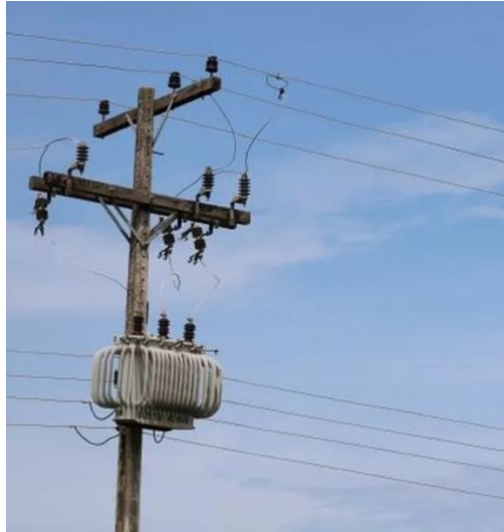
Figura 2 – Rede de distribuição aérea com condutores nus
