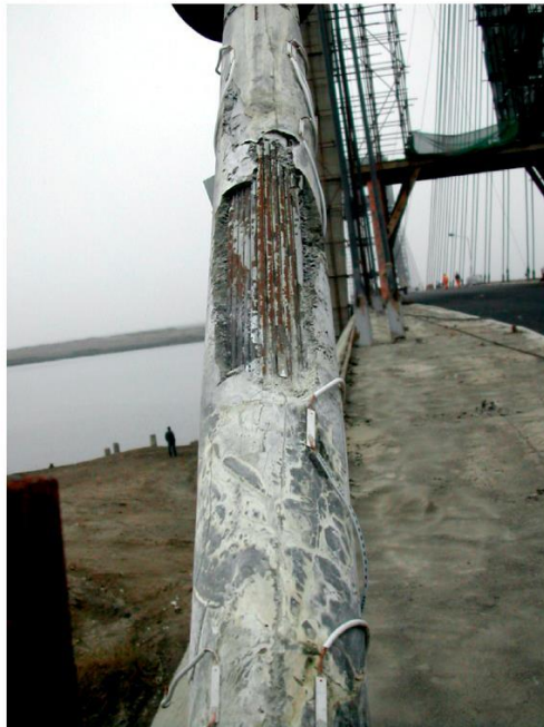
Figura 31 – Danos apresentados em cabos estiadados, mostrando corrosão nos fios de aço após abrir uma janela de inspeção.
