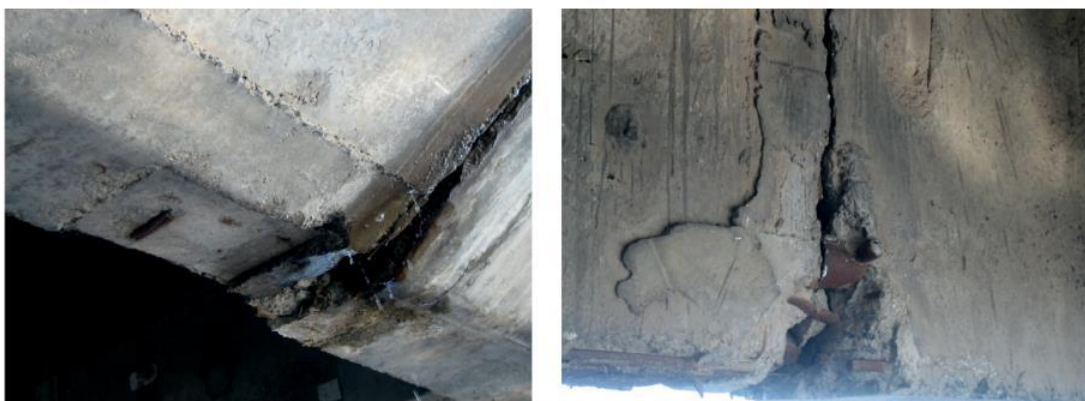
Figura 30 – O dano estrutural encontrado no vão principal. (a) aberturas severas na face inferior da viga. (b) Fratura da barra de aço embutida no concreto.
