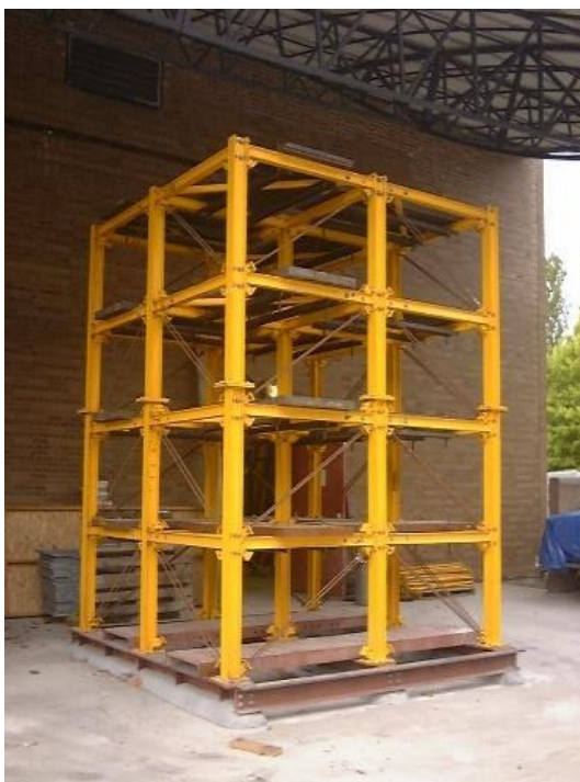
Figura 14 – Foto global do YF e o local da instalação, mostra vigas, colunas e contraventamento
